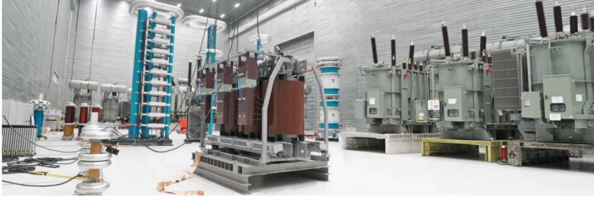
Astor Enerji Test Laboratuvarından bir bölüm
