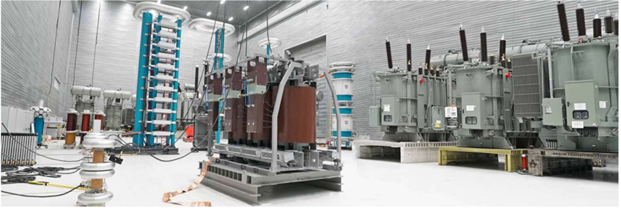
Astor Enerji Test Laboratuvarından bir bölüm
